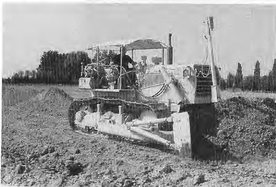
Fig.10 In questa foto si può vedere una ruspa già provvista di un'asta di riferimento con dei fotodiodi che provvedono, grazie ad un circuito supplementare, ad alzare o ad abbassare automaticamente la pala in base al livello del fascio Laser.
